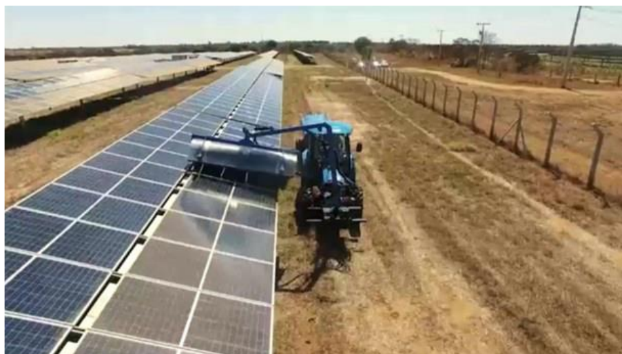
Figura 3.11 – Exemplo de limpeza dos módulos fotovoltaicos
