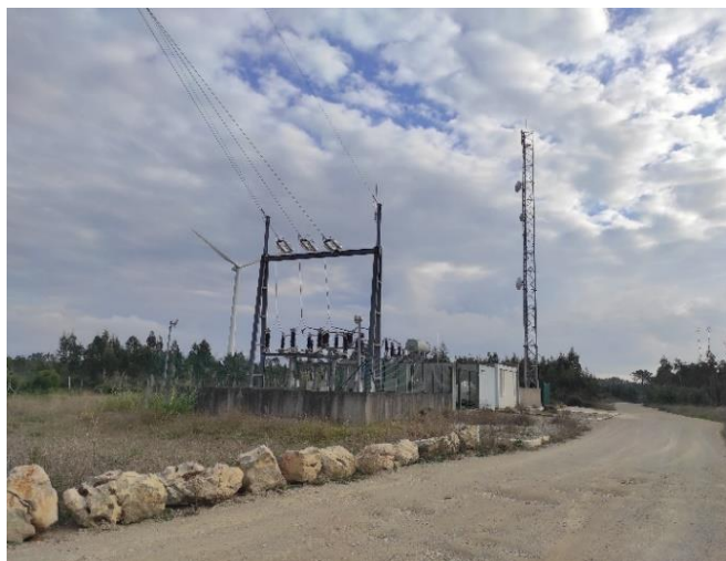
Figura 4.62 – Subestação do Parque Eólico da Serra d'El Rei
